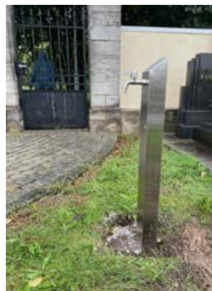
Jeden z nových kohoutků na užitkovou vodu na hřbitově
