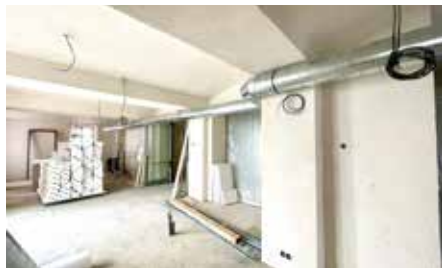
VZDUCHOTECHNIKA V PŘÍZEMÍ
