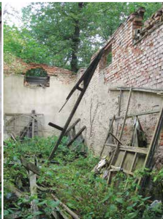
Havarijní stav budov za kinem
