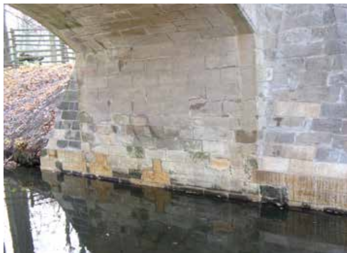
Vyměněné pískovcové kvádry
