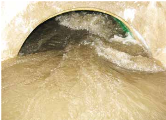
„Peřej“ v revizní šachtě při otevření na 50 %
